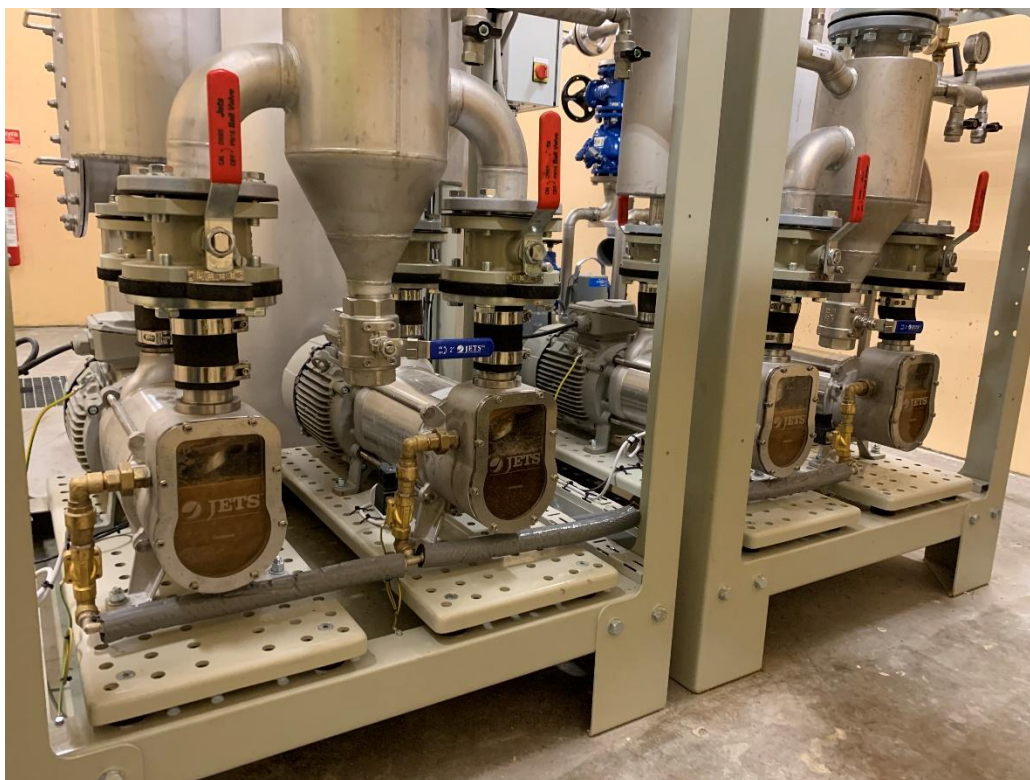
Figur 6 De fyra jetspumparna i pumpstation Jeppe.
