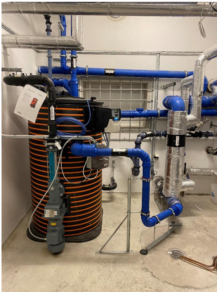
Foto – Pumpsump för kvarnat matavfall i fastighet i Oceanhamnen
