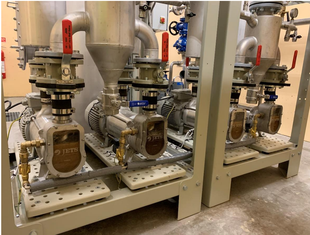
Figur 6 De fyra jetspumparna i pumpstation Jeppe.
