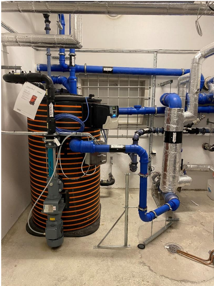
Foto – Pumpsump för kvärnat matavfall i fastighet i Oceanhamnen
