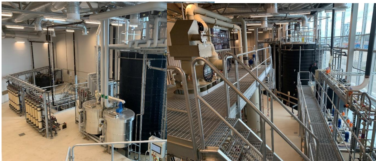
Figur – Foton på installerad processteknik i RecoLabs utvecklingsanläggning. Exklusive utrymme för ställverk som inte ses i bilden.
