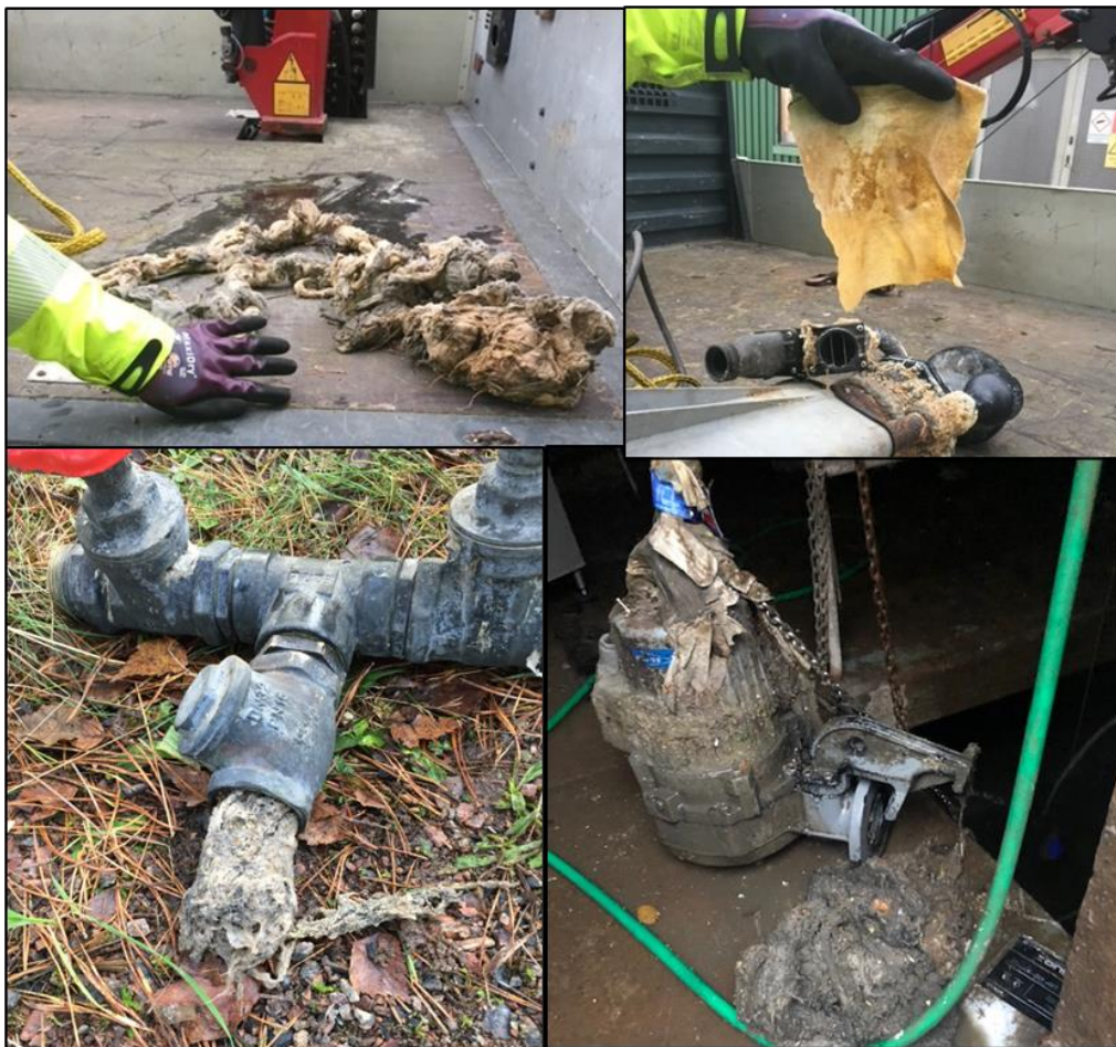
Våtservetter som sätter igen pumpar i pumpstationer.
