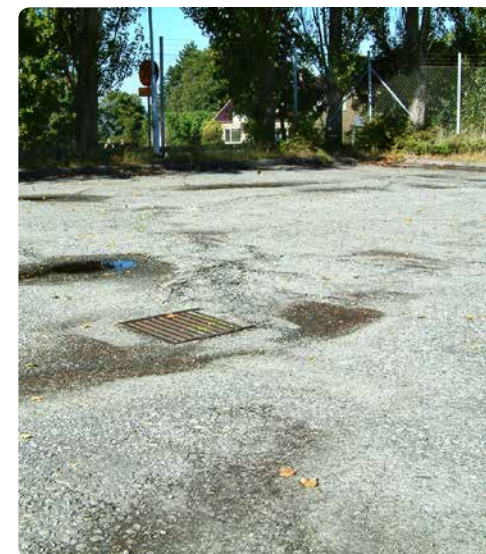
Det blir ofta sättningar runt rännstensbrunnar.
