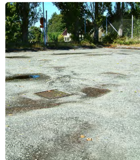
Det blir ofta sättningar runt rännstensbrunnar.
