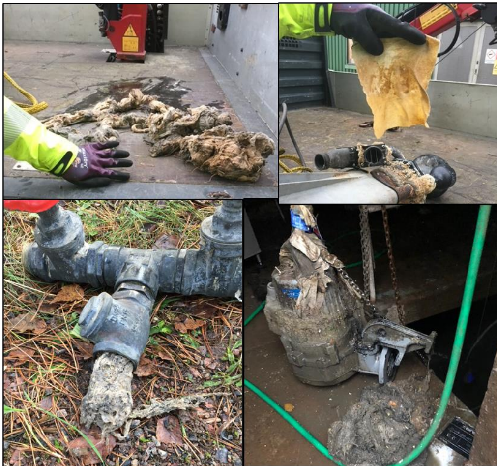
Våtservetter som sätter igen pumpar i pumpstationer
