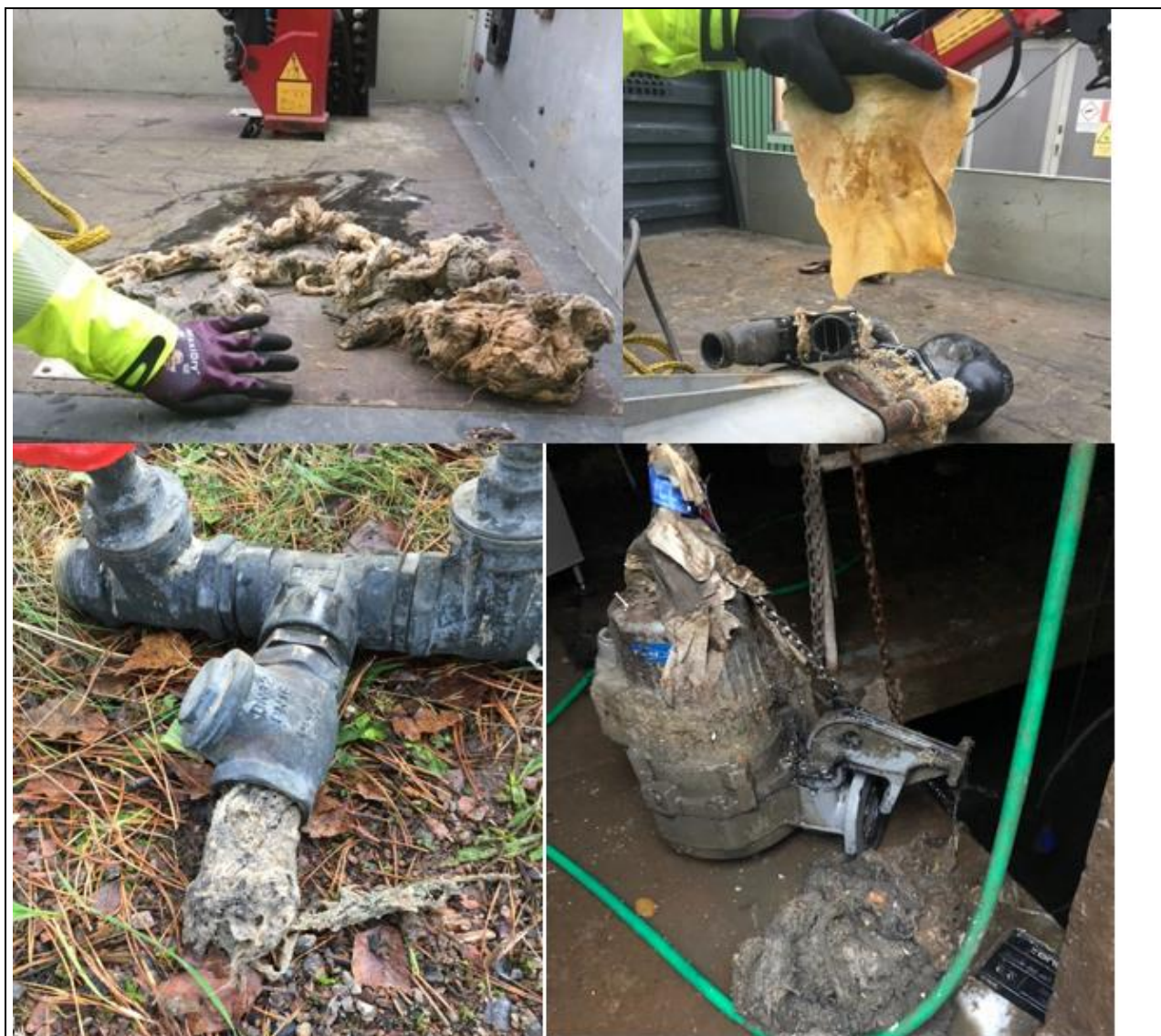
Bilder: Våtservetter som sätter igen pumpar i pumpstationer
