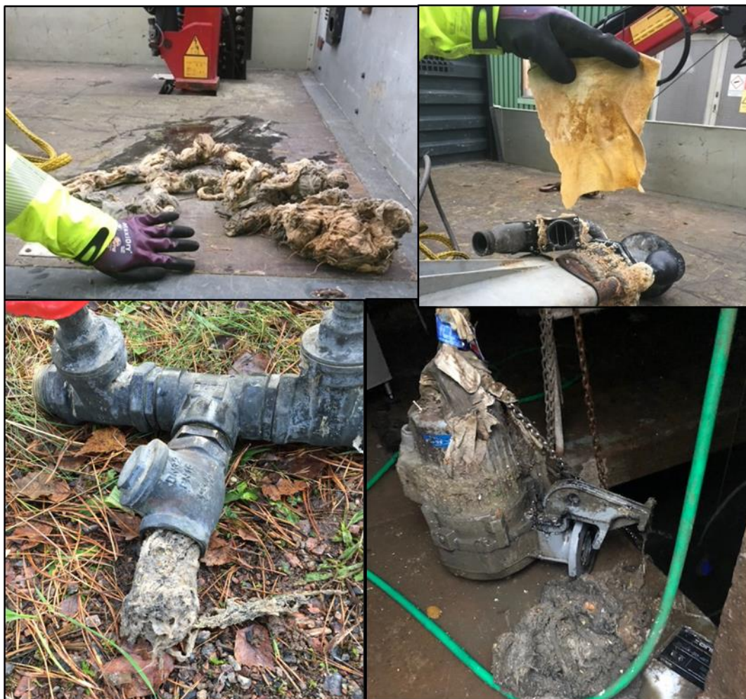
Våtservetter som sätter igen pumpar i pumpstationer
