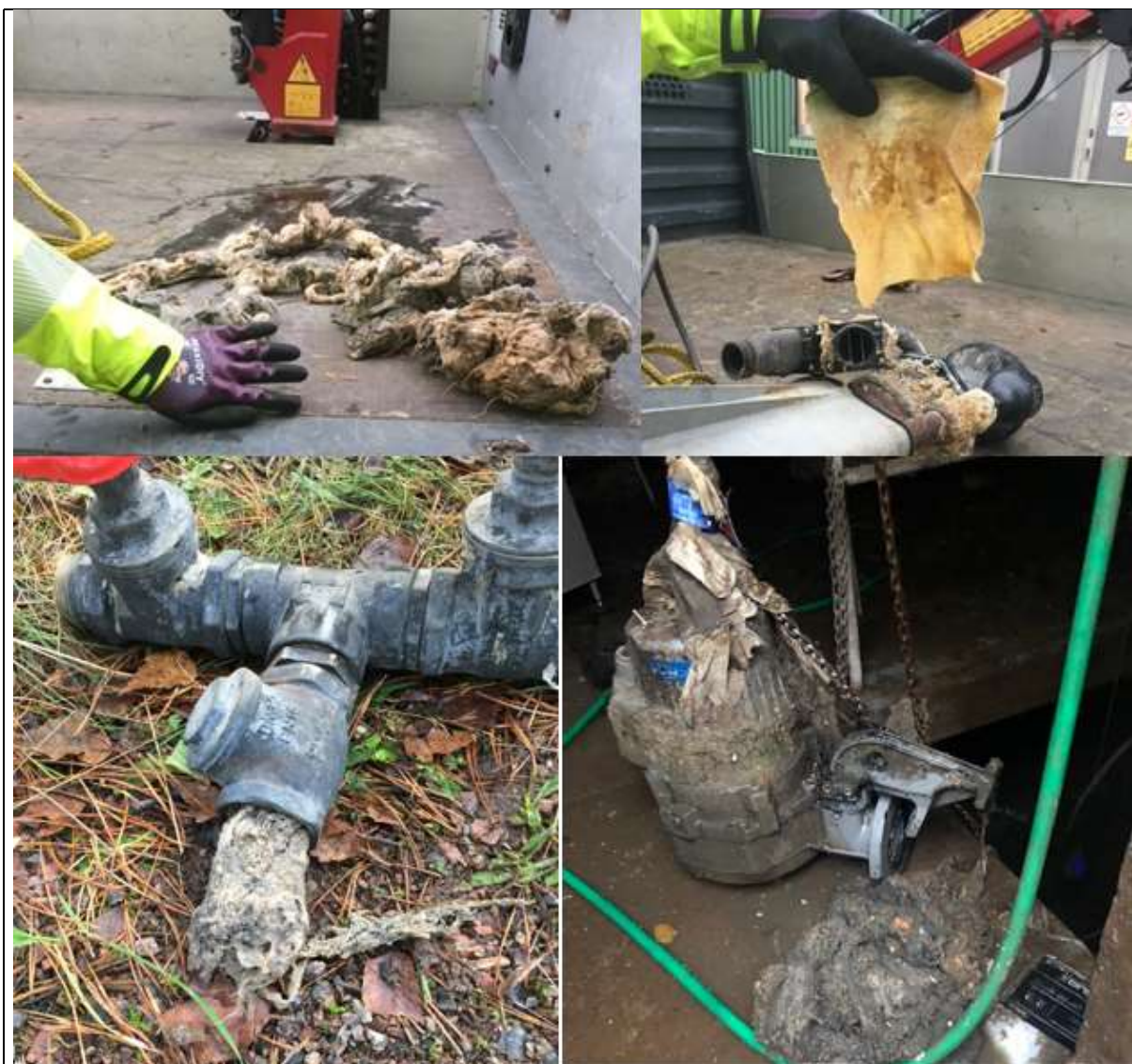
Bilder: Våtservetter som sätter igen pumpar i pumpstationer
