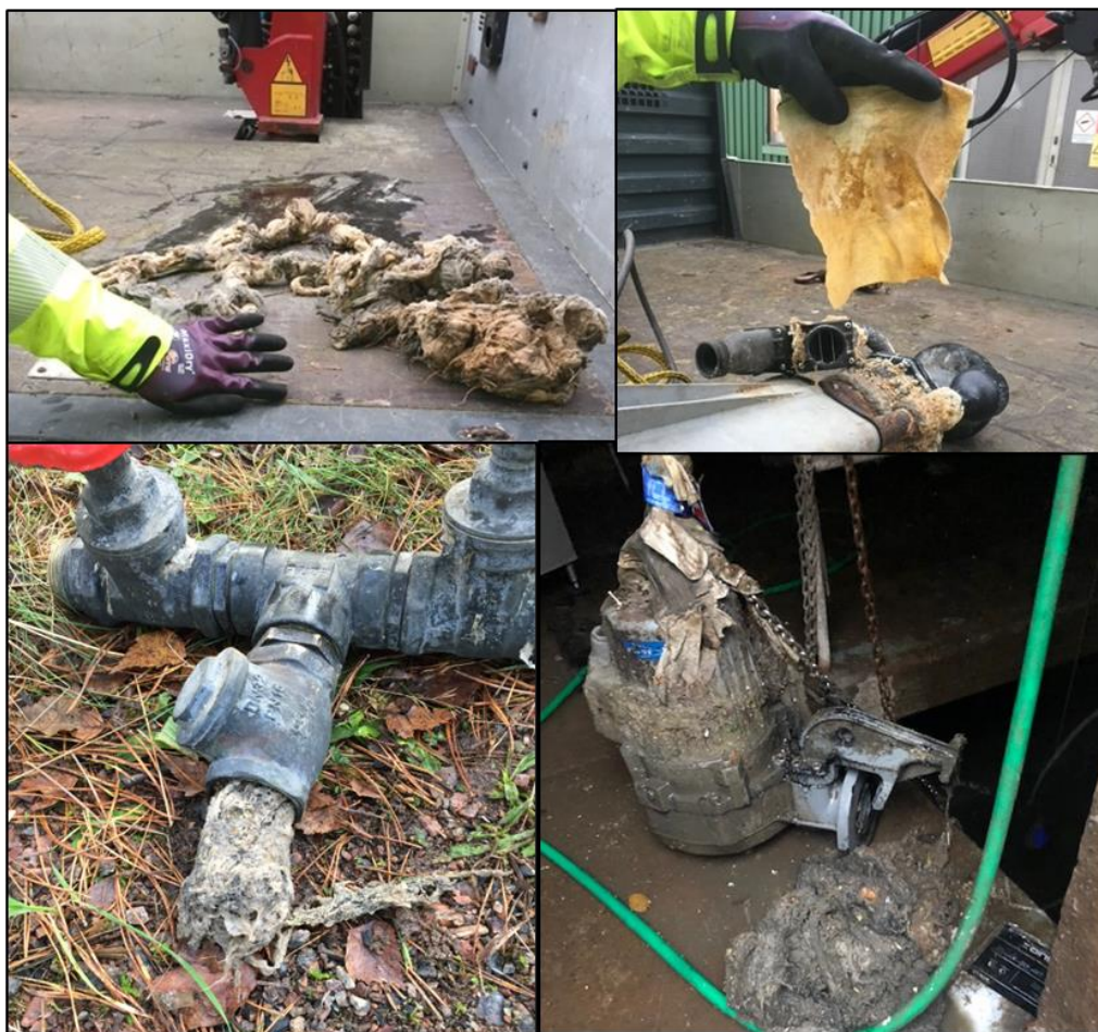
Våtservetter som sätter igen pumpar i pumpstationer.
