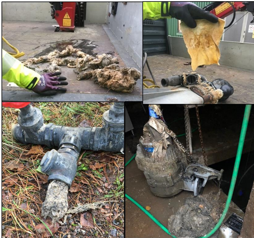
Våtservetter som sätter igen pumpar i pumpstationer.
