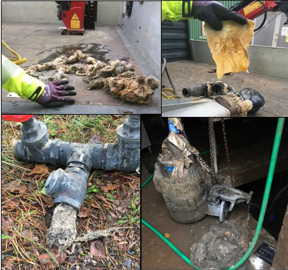
Våtservetter som sätter igen pumpar i pumpstationer
