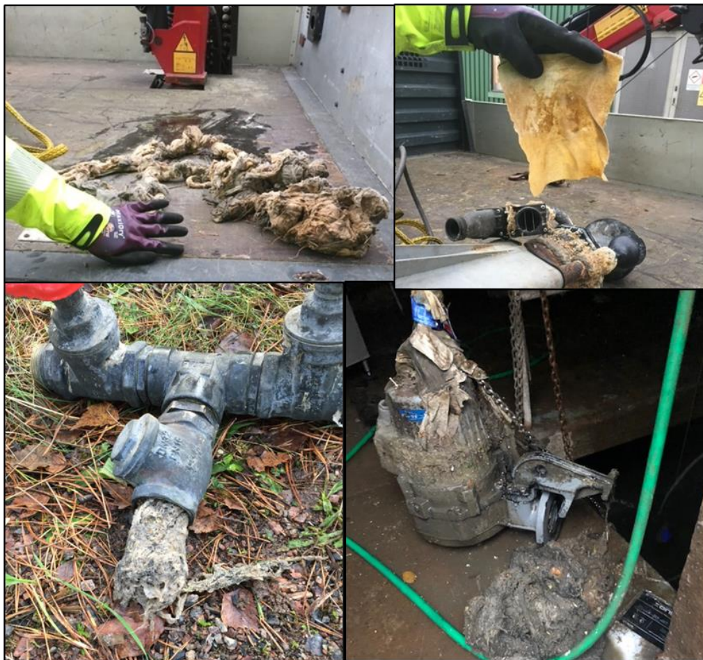
Våtservetter som sätter igen pumpar i pumpstationer
