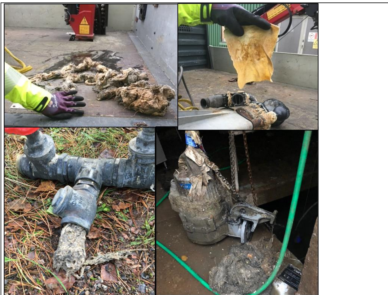
Våtservetter som sätter igen pumpar i pumpstationer
